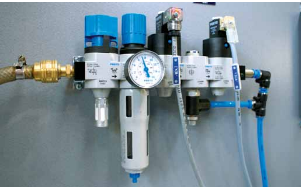
Eine Wartungseinheit der D-Reihe mit zwei elektrischen Einschaltventilen zur Erhöhung der Sicherheit.
